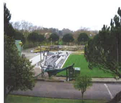
ETAR de Ponte de Moreira
